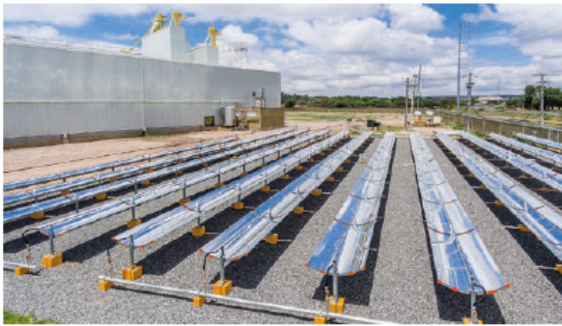
Colectores cilindro-parabólicos instalados en Comercial Forrajera de Lagos (COMFOSA) en México Foto: COMFOSA
